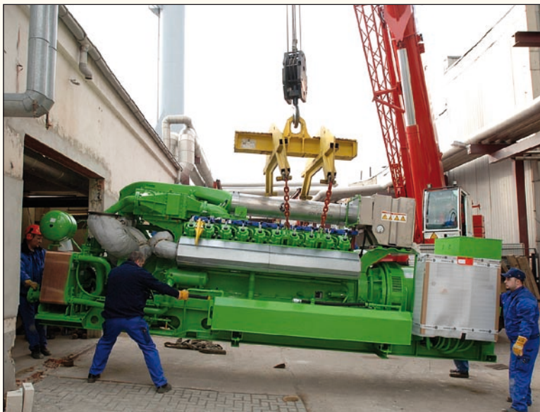
Herzstücke in grün: Zwei Biogasmotoren für die Stromerzeugung sind bereits geliefert.
